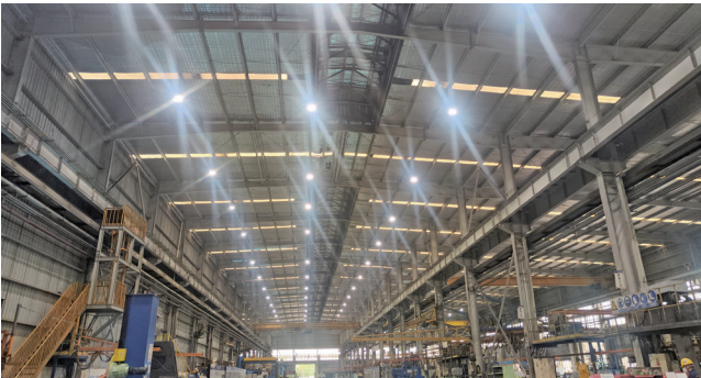
车间顶LED节能灯
