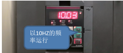
改善后风机联控
