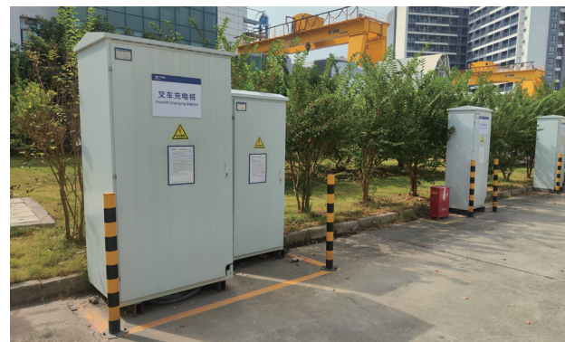
⑤新能源车充电桩
