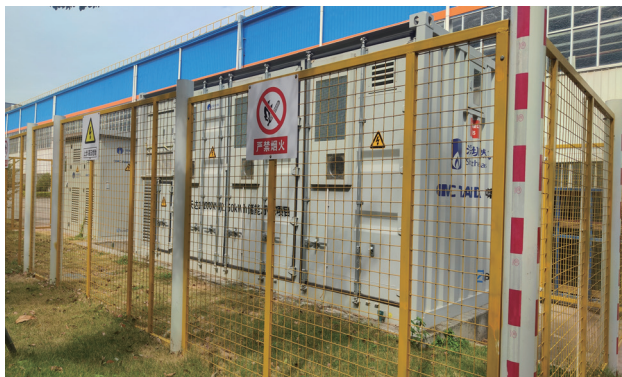
②储能电站
